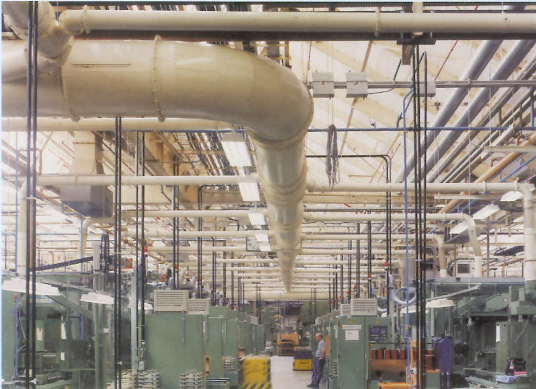
Rohrleitungs-Förderweg einer zentralen Öl- und Emulsions- Absaug-Anlage
